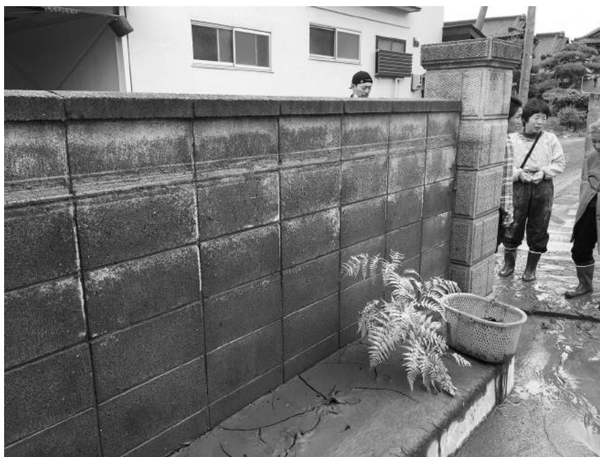
コンクリート塀に付着した泥の線が高水位
